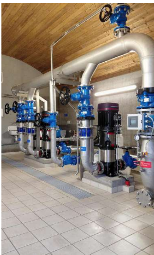
Intérieur de la station
